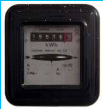
4.attēls. Elektrības skaitītājs
